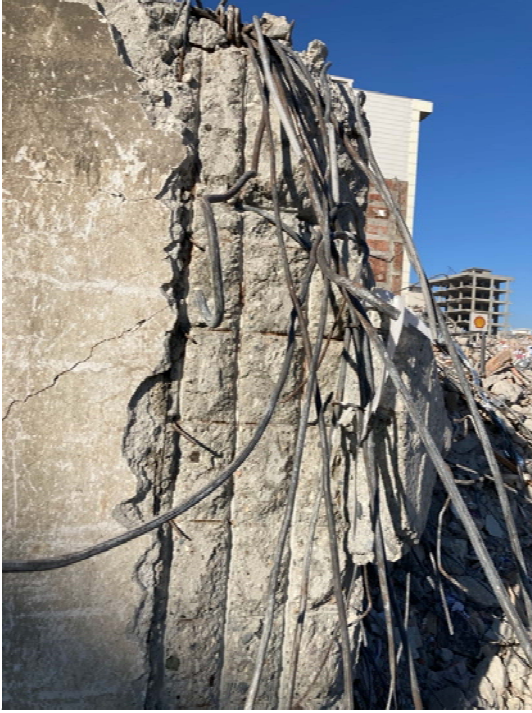
Resim 7: Otelin yıkılmamış kısmındaki kolon
